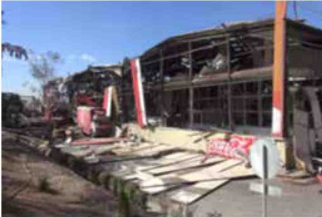
الصورة (1) تظهر حجم الدمار الذي تعرضت له إحدى منشآت القطاع الخاص
