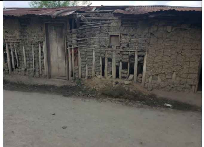
Figure 2. Une maison d'une famille des retournés détruite pendant la fuite et l'insécurité à Bulongo
