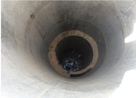
Photo 1 : puits ouvert rempli de détrit à Kalait après l'inondation
