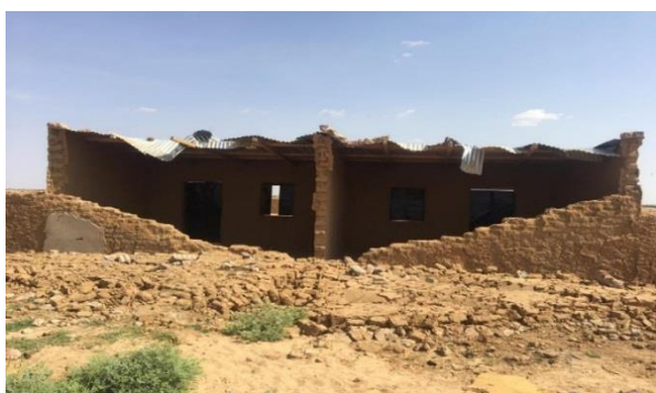
Photo 7 : Maison endommagée par l'inondation à Kalait
