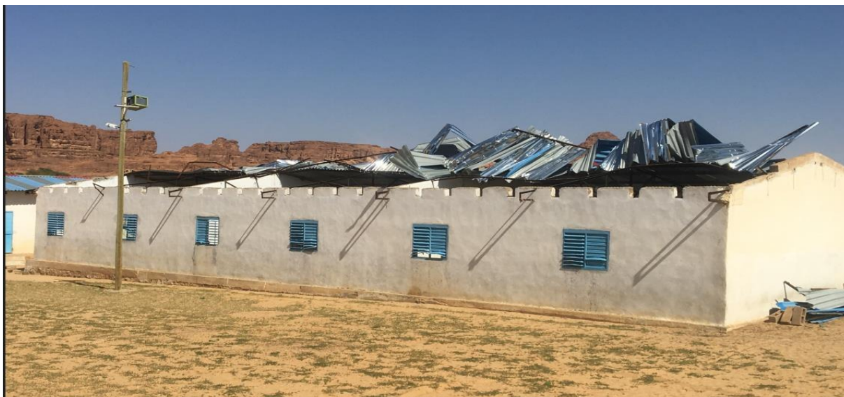
Photo 5 : toit de l'école de Yogorong détruit à Fada
