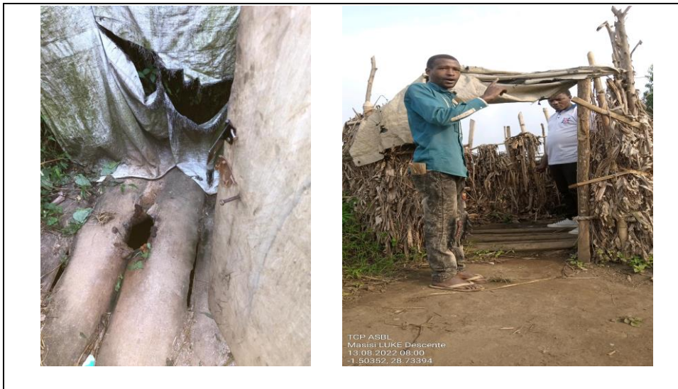
Figure 11: état d'une latrine à ciel ouvert dans la zone sans superstructure
